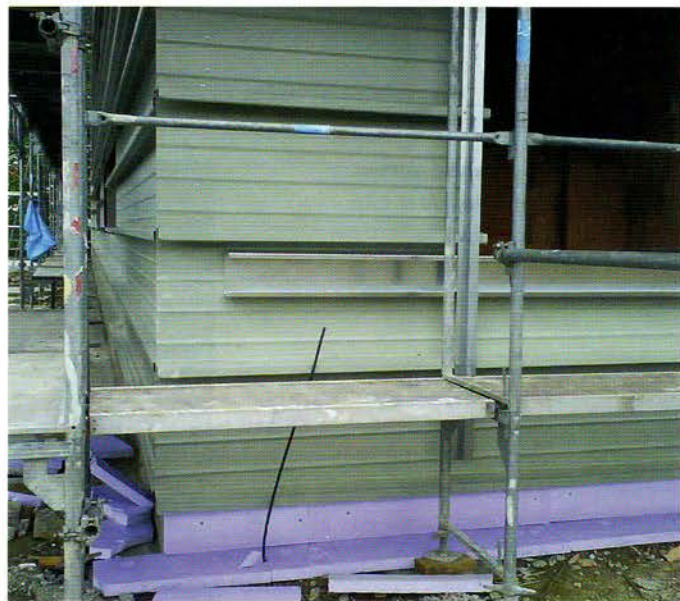
Die Sidings wurden an der Stahlkassette mit 150x 600 millimetern Baubreite befestigt. Bevor Fenster und Türen eingebaut werden konnten, mussten die Öffnungen millimetergenau angelegt und ausgesteift werden.
